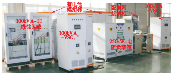
图10 微网系统实验平台
